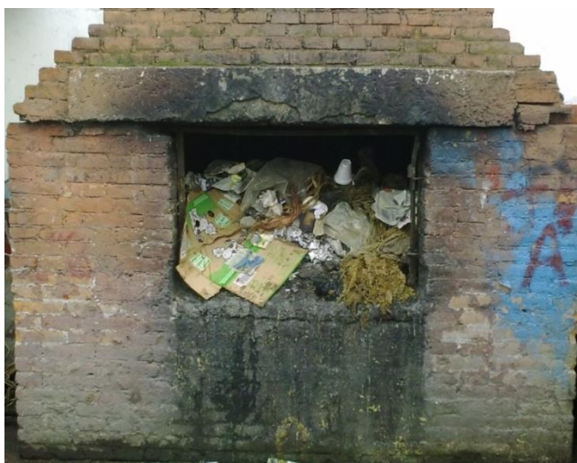
Figura 3. Incinerador del rastro destinado a la quema de residuos cárnicos y que también es utilizado para otro tipo de residuos
