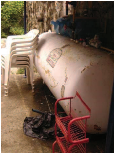
Figura. 7. Sustancias peligrosas almacenadas.
